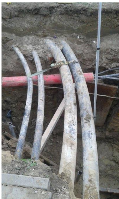
Rys. 6. Kolizja przy studni S13
